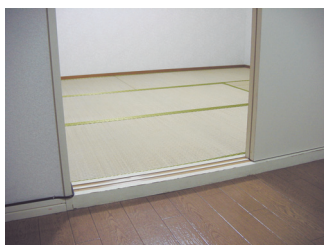
▲③①室内の敷居の段差
